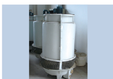
冷却水塔 Cooling Tower
