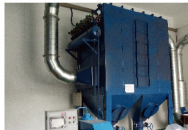
布袋除尘器 Dust Removal Device
